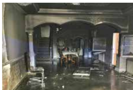
Der abgebrannte Raum des Hauses. (Foto: FF Gerasdorf)
