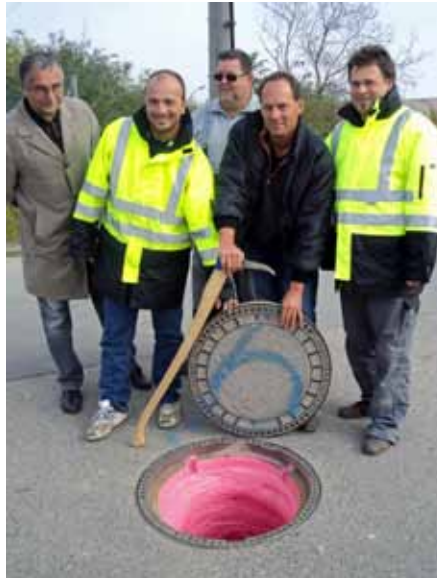
Vbgm. J. Kaller u. Kanalchef K. Bauer mit den Mitarbeitern der deutschen Spezialfirma: 10 Kanalschächte wieder dicht.
