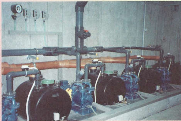
Kanalvakuumstation in Kapellerfeld und Seyring.
