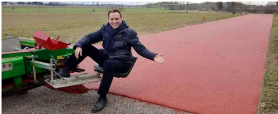
Bgm. Vojta bei der neuen Laufbahn. Die Fertigstellung erfolgt in den nächsten Wochen. (Foto: GGK)
