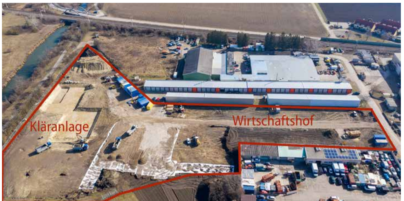
Drohnenfoto von März 2021 von der Baustelle in der Fabriksgasse (Foto: City Copter Cam)
