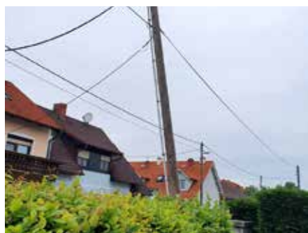
Der Mast in gefährlicher Schräglage. (Foto: FF Gerasdorf)
