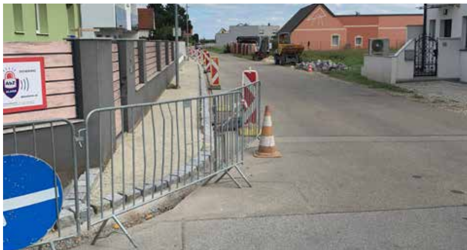
Um die Sicherheit der Fußgänger zu erhöhen wird der Gehsteig entlang der Wienerstraße errichtet. (Foto: NÖN/Winter)
