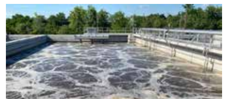
Durch biochemische Reinigung des Abwassers wird die Belastung durch organische Verbindungen reduziert. (Foto: GGK)
